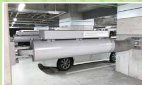
▲オイルダンパー[24基]
