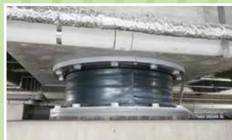
▲アイソレータ(積層ゴム)[132基]
